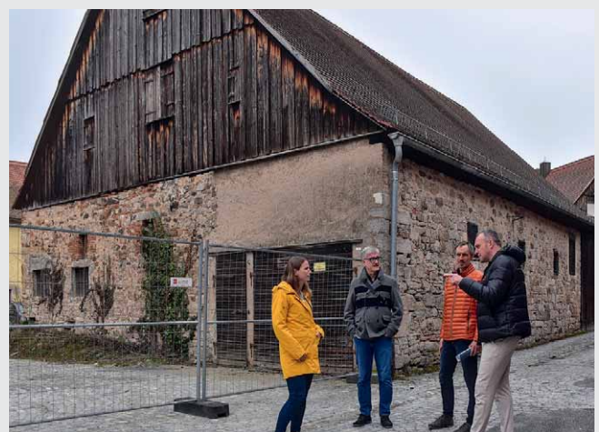
In der historischen Roßmühle am Huppmann-Banse-Areal in Feuchtwangens Altstadt soll ein modernes Gesundheitszentrum entstehen. Über das geplante Sanierungs- und Nutzungskonzept sprachen erster Bürgermeister Patrick Ruh (2. v.l.) und KUVorstand Arthur Reim (r.) mit den künftigen Betreibern Eva und Moritz Müller.
