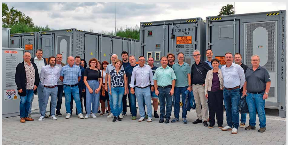
Vertreterinnen und Vertreter der Stadt und der Stadtwerke Feuchtwangen feierten gemeinsam mit ihren Projektpartnern die offizielle Inbetriebnahme des innovativen Batteriespeichers in Feuchtwangen.
