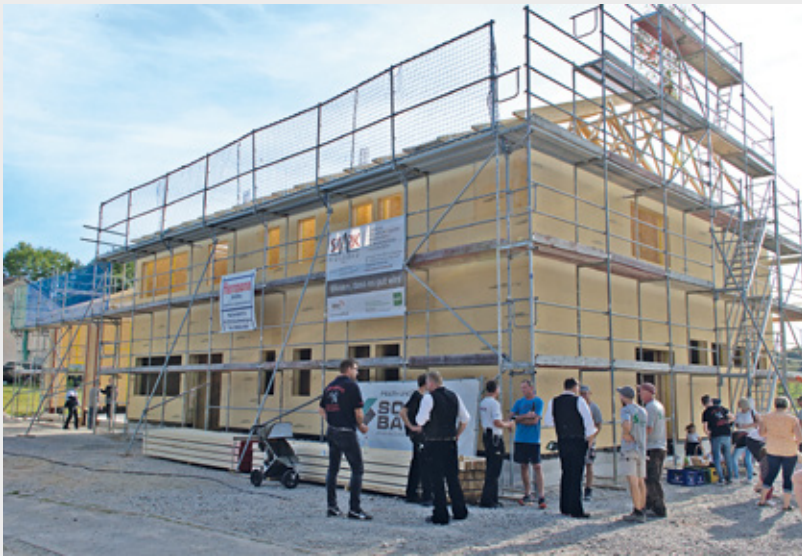
Der Rohbau samt Dachstuhl des neuen Feuerwehrgerätehauses mit Gruppenraum für die Jugend in Krapfenau steht. Nun wurde traditionell Richtfest gefeiert.
